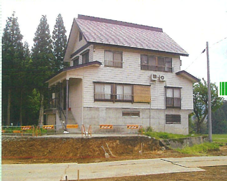
地震でL型擁壁が倒壊して最大18cm沈下
