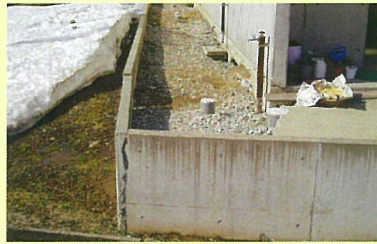
L型擁壁も破損している現況
